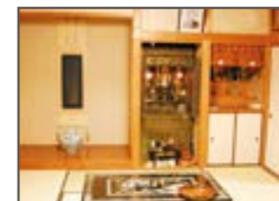
和室の例：床部分に断熱材や気流止めが施工されていない。
