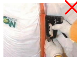
悪い施工例②
