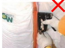
悪い施工例②
